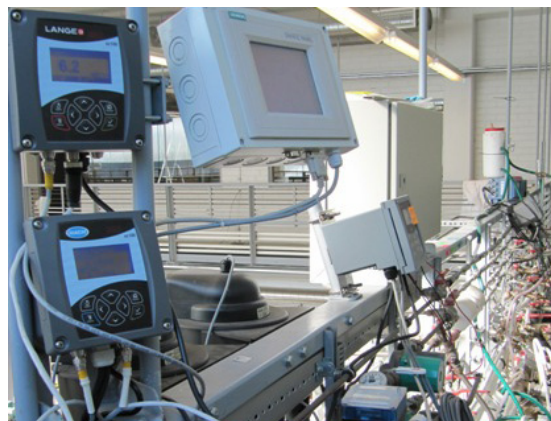
Koevesijohtoverkosto online monitorointilaitteineen.
