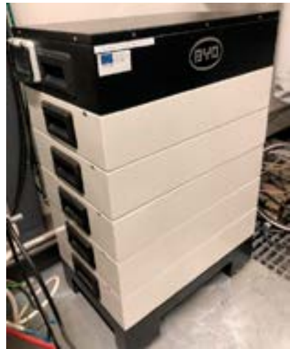
Kuva 51. Aurinkojärjestelmän akusto tutkimuskeskuksessa
