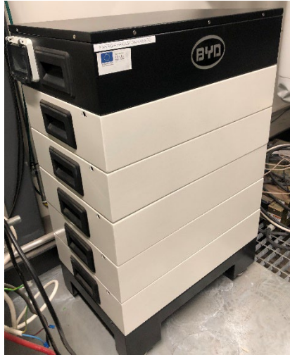
Tutkimuskeskuksessa aurinkojärjestelmän akusto
